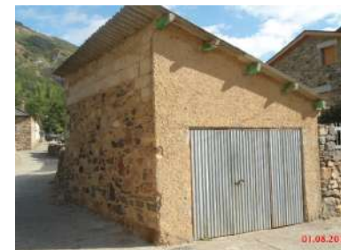
Ejemplo de edificación con amianto (1658207QH1599N0001XJ)
